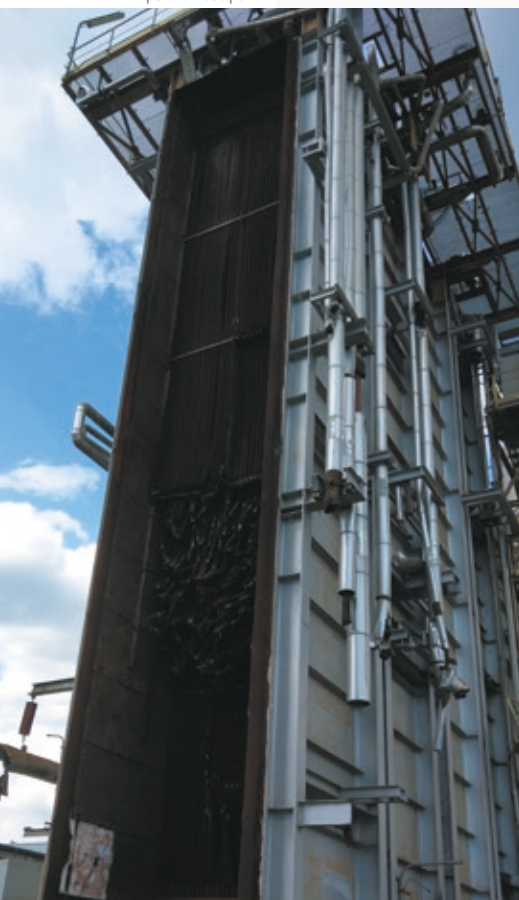
Vista dell'interno del case del generatore a vapore a recupero e dei moduli di scambio termico interno
